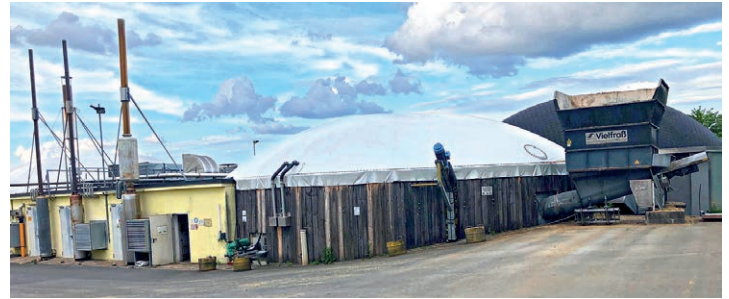
Aufbau der Biogasanlage Volkert in Kammerstein: Durch den „Vielfraß“-Trichter (rechts) wandern die Pflanzen in den „Fermenter“ (Mitte, mit weißer Plane als Dach), wo sie vergären. Das entstandene Methan treibt drei Motoren (links) an.
